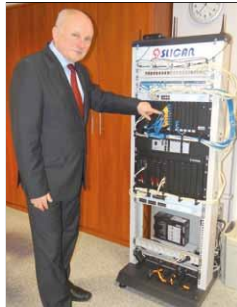
Właściciel firmy „Waltel” przy stojaku szkoleniowym 19 cali, który zawiera trzy centrale telefoniczne - małej, średniej i dużej pojemności.
